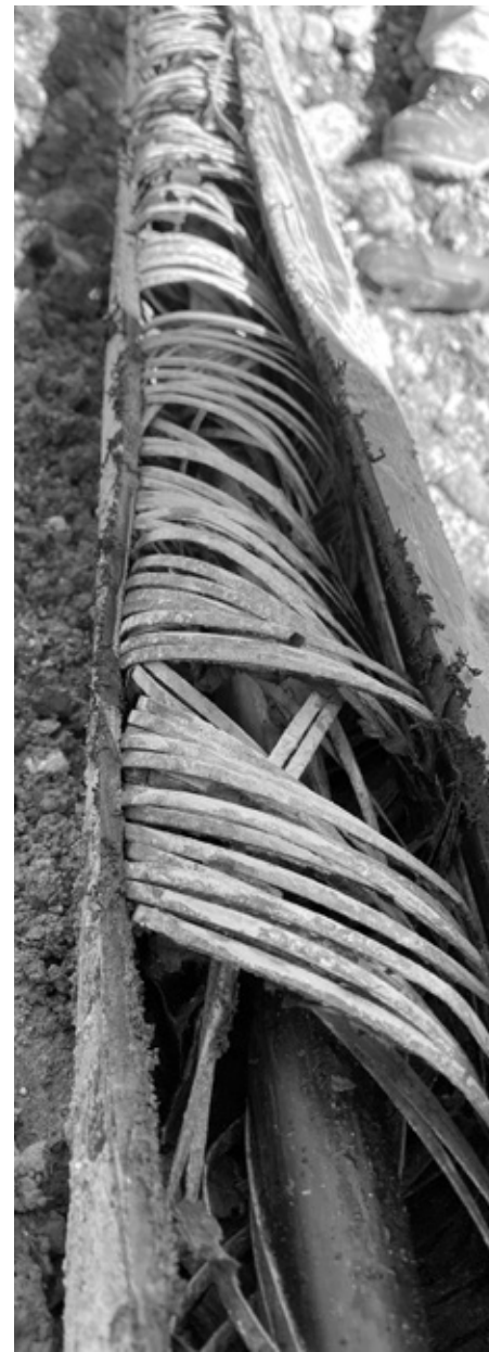
Teilansicht einer Werkleitung.
