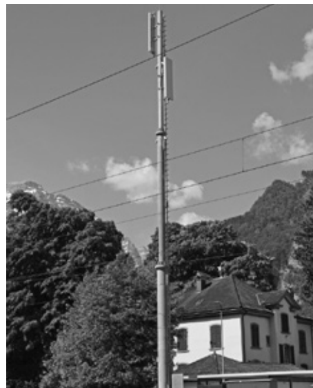
Die neue Antenne der SBB südlich des Bahnhofs. (Foto: Christian Bosshard)
