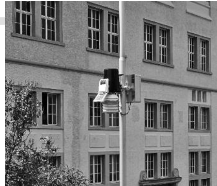
Die Wetterstation beim Löntschkraftwerk ist Teil des schweizerischen Wetter-Frühwarnsystems. (Foto: Jakob Kubli)
