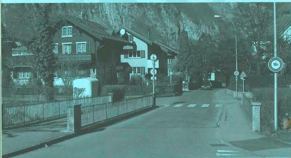
Die Mattbrücke muss saniert oder neu gebaut werden.
